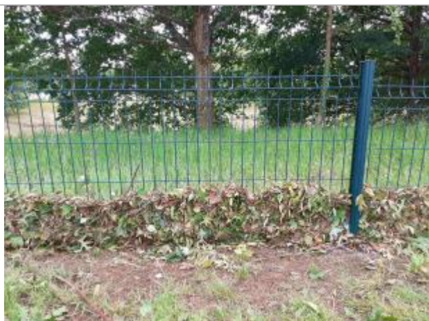
Végétations retenues dans le grillage de 25 à 37 cm de hauteur à partir du sol en terre, en amont d'un bassin de rétention
