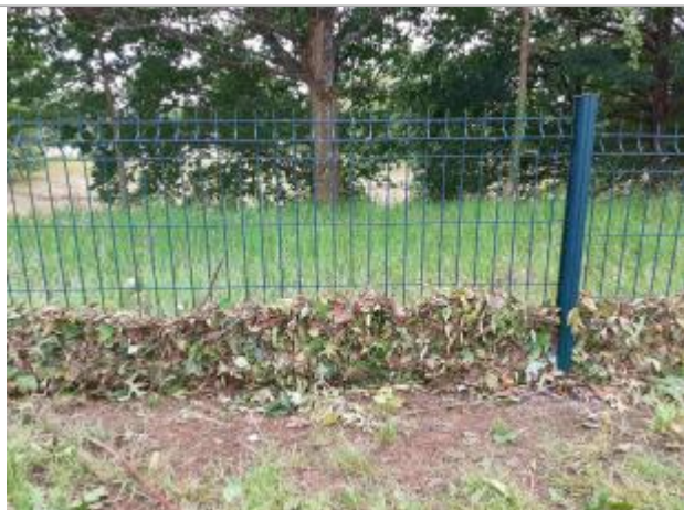
Végétations retenues dans le grillage de 25 à 37 cm de hauteur à partir du sol en terre, en amont d'un bassin de rétention
