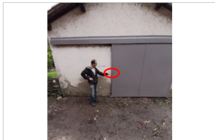
laisse de crue sur la porte de la remise
