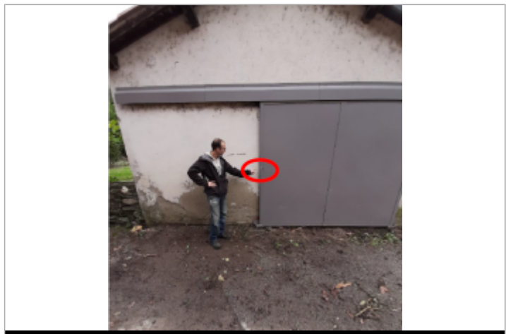
laisse de crue sur la porte de la remise
