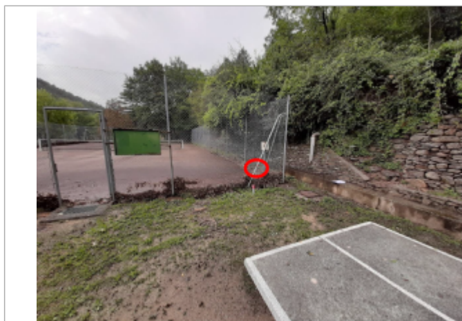
Trace de peinture sur poteau du tennis
