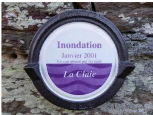
Repère normalisé de l'inondation de janvier 2001
